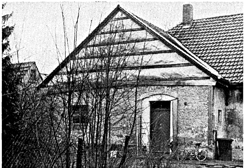
EINSATZ für ein würdiges Leben: Zwei Zimmer in einem Haus mit undichtem Dach (unser Bild) sind die Unterkunft, mit der eine achtköpfige Flüchtlingsfamilie aus dem Iran nun schon seit zweieinhalb Jahren Vorlieb nehmen muß. Versuche der Dachauer Initiative „Arbeitskreis Asyl“, eine annehmbare Wohnung zu finden, waren bisher noch nicht erfolgreich.
